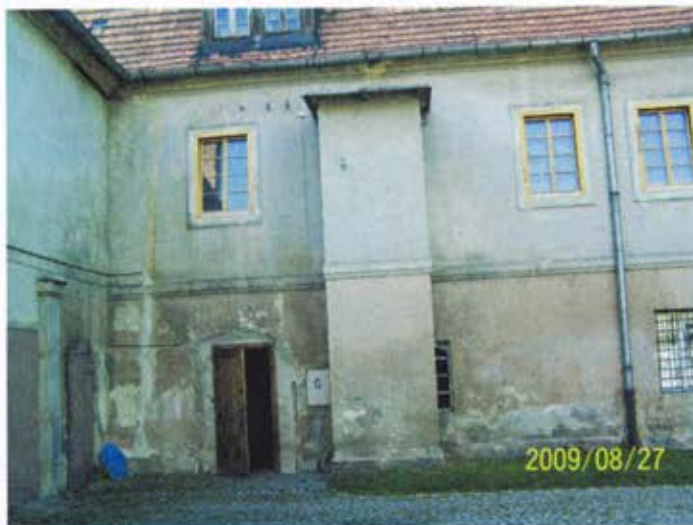
Zawilgocenie narożnika ścian – narożnik ściana tylna budynku głównego/ściana boczna łącznika, wilgoć w strefach przyziemia
