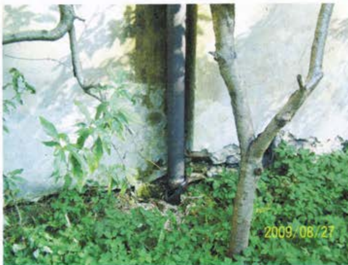
Wykruszenia muru oficyny w strefie przyziemia wskutek pęknięcia i braków rury spustowej na styku rury pcv i kołnierza żeliwnego
