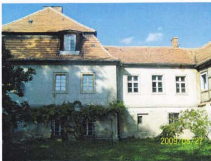
Zawilgocenie narożników ścian budynku głównego, łącznik-oficyna na całej wysokości
