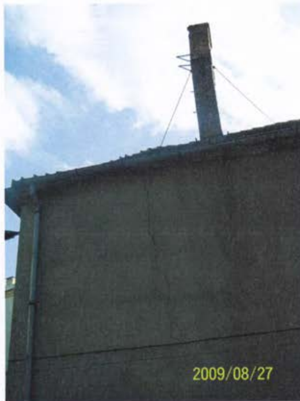
Przechył komina murowanego ponad dachem oficyny
