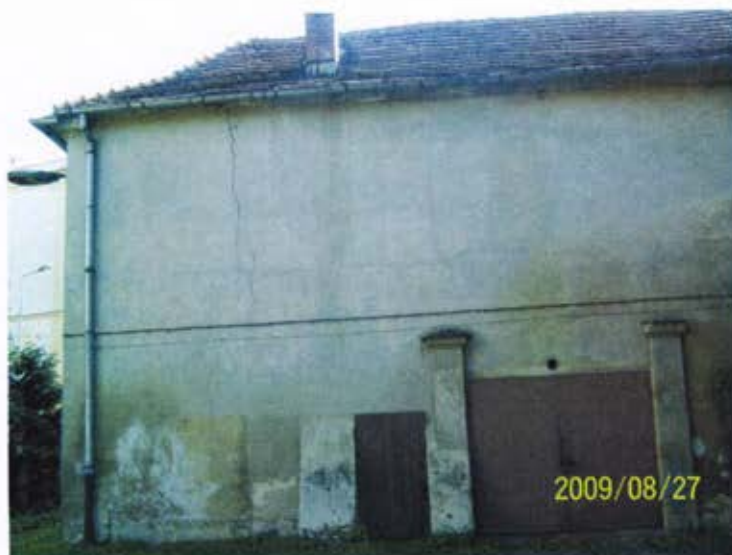
Pęknięcie ściany oficyny na wysokości I piętra – ściana boczna łącznika
