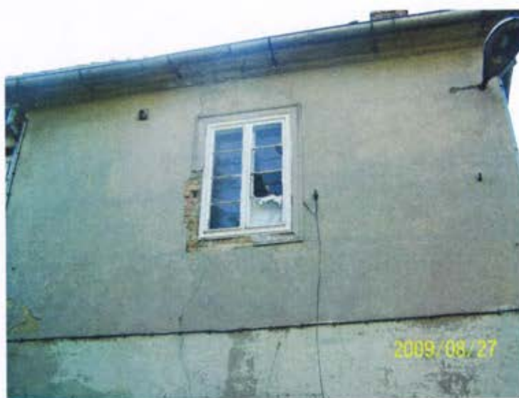
Zarysowania pod oknami, nad nadprożami, gzymsem – ściana tylna łącznik-oficyna
