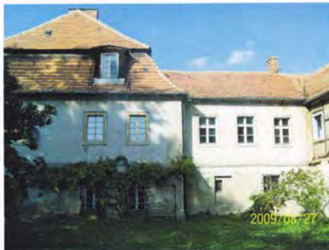
Zawilgocenie narożników ścian budynku głównego, łącznik-oficyna na całej wysokości
