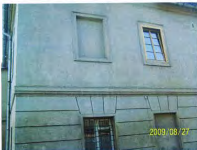
Zarysowania nad i pod oknami – ściana boczna budynku głównego
