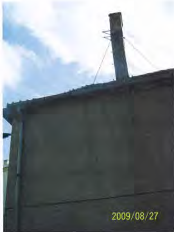
Przechył komina murowanego ponad dachem oficyny
