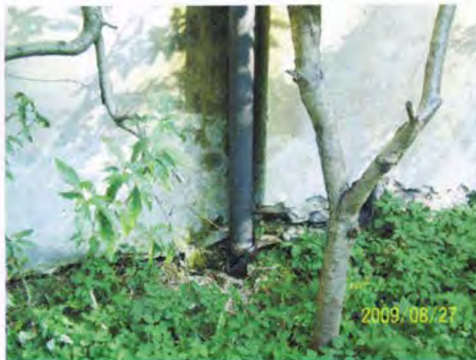
Wykruszenia muru oficyny w strefie przyziemia wskutek pęknięcia i braków rury spustowej na styku rury pcv i kołnierza żeliwnego
